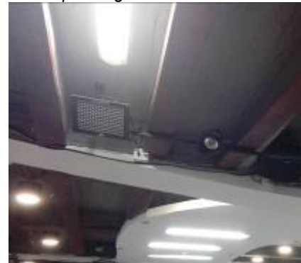
Fotografía No. 8 Sistema Cloud en techo
